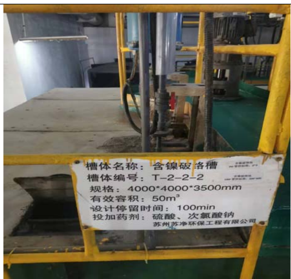
含镍废水破络池
