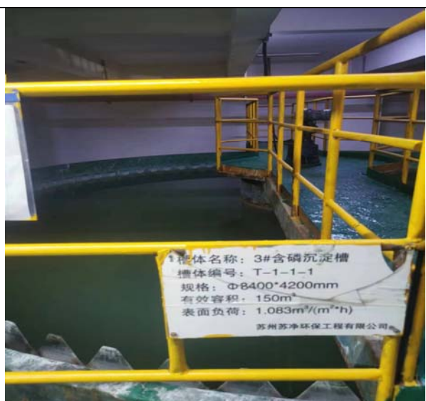
含磷废水沉淀池
