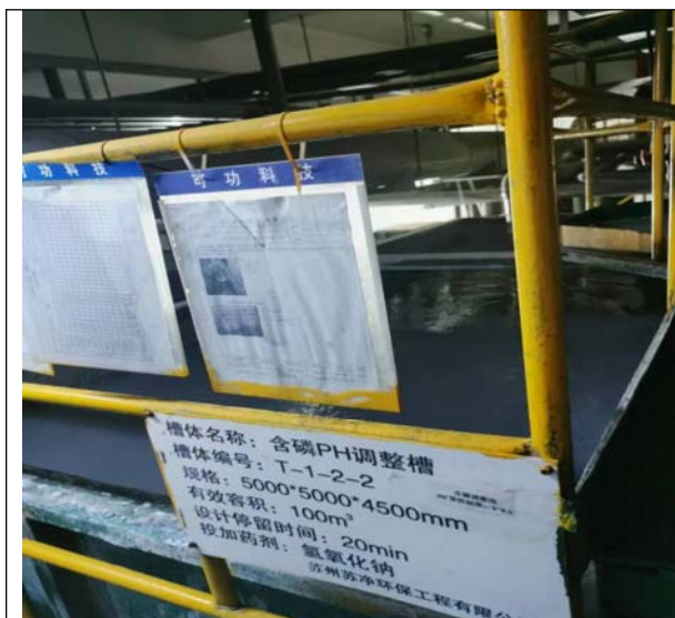
含磷废水 pH 调节池
